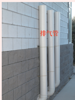
图3 房屋两侧的排气管
