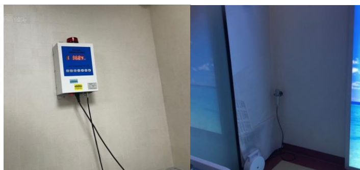
图 4-4 射波刀机房固定式剂量报警仪、电离室巡测仪和个人剂量报警仪
