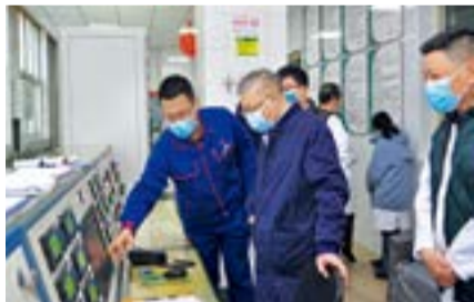
金昌晓书记一行了解供暖锅炉管道、洗衣机等设备运行和维护情况
