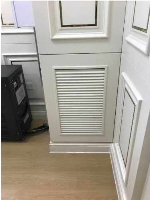
(机房墙角处排风口)
