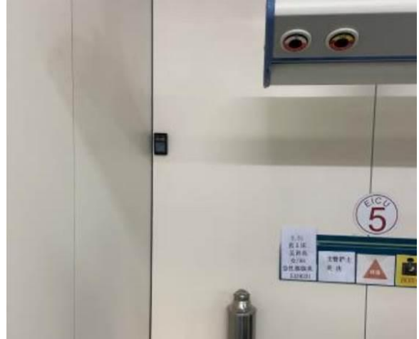
(机房楼上急诊监护室内报警仪)
