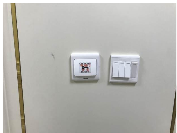
(防护门内侧紧急开门按钮)
