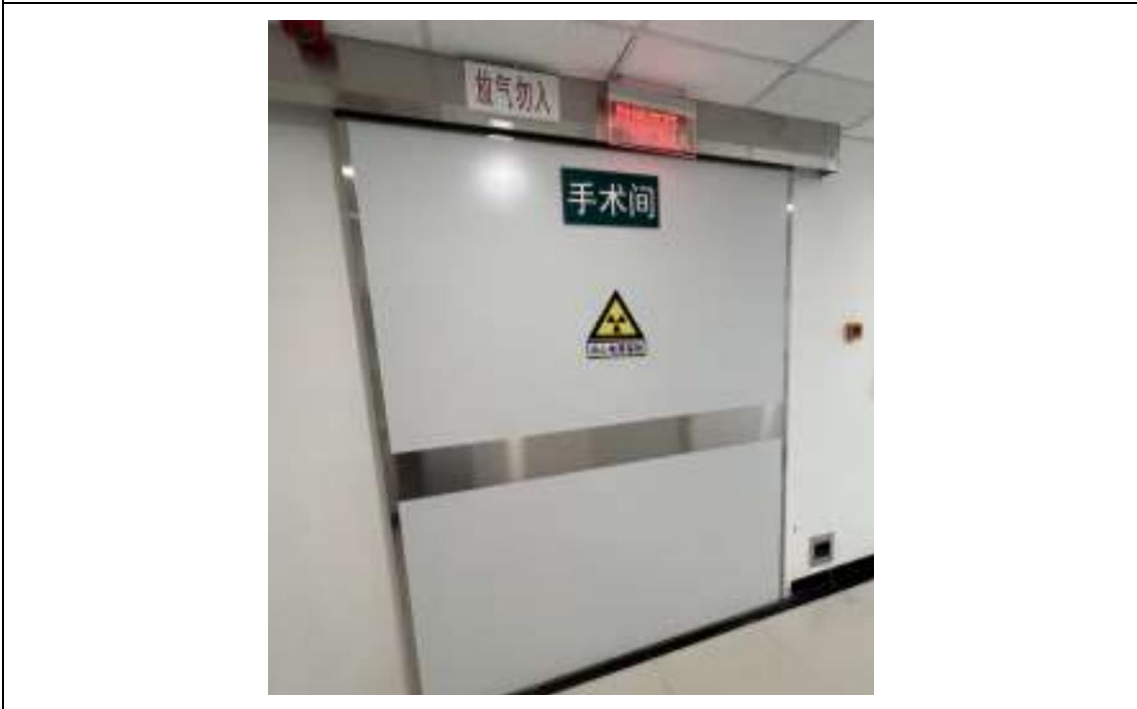
图 4-2 警告标志等辐射防护设施
